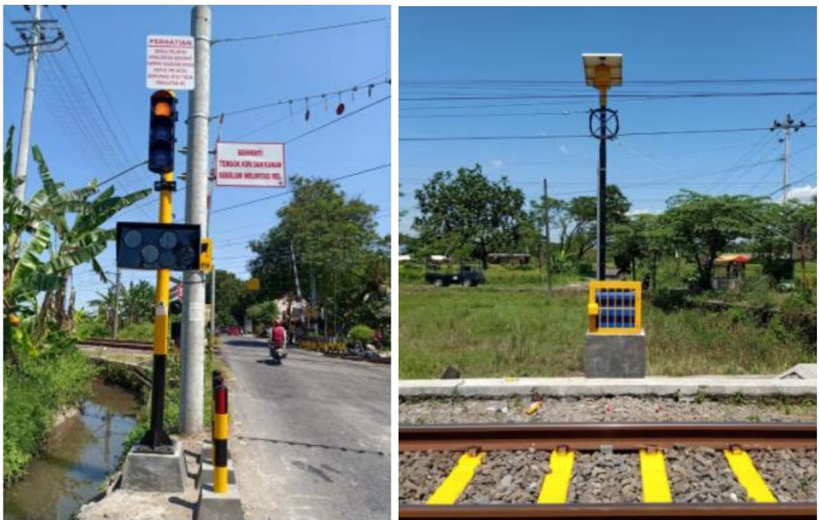
Gambar 3.9 Fasilitas Keselamatan Jalan Terpasang (EWS) di Perlintasan Sebidang Kereta Api JPL 251 Kabupaten Klaten
