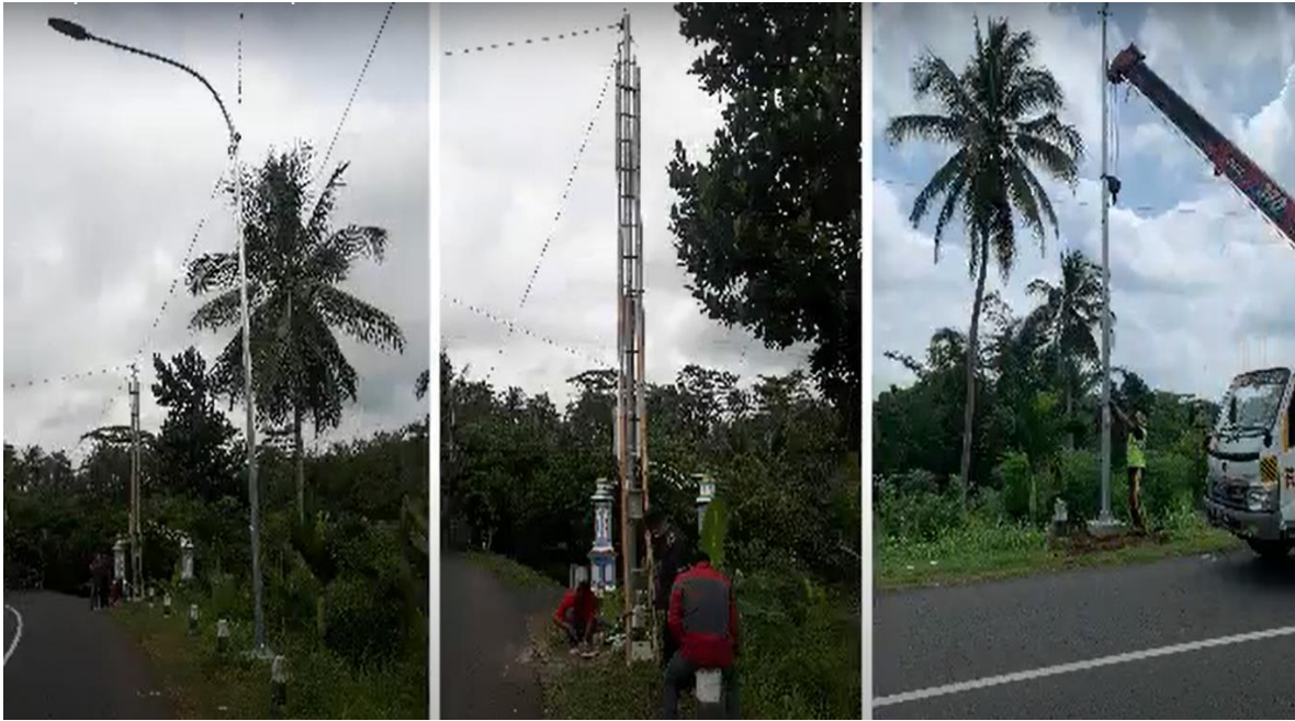
Gambar 3. 3 Penyediaan Perlengkapan Jalan (LPJU) Terpasang Ruas Jatibarang - Ketanggungan
